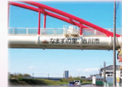
「中川水管橋」に「なまりん」のイラストや文字を入れて市外にPR！
